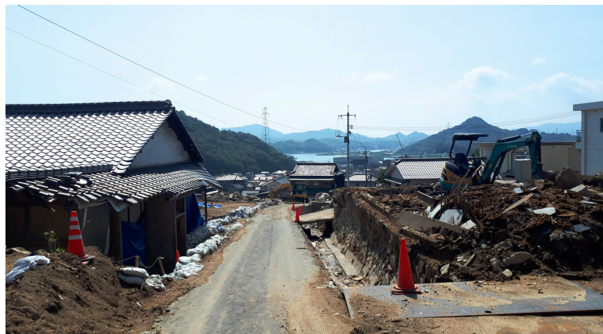
豪雨災害による土砂崩れで倒壊した家屋（右側） 居住できなくなり取り壊しを待つ家屋（左側）
